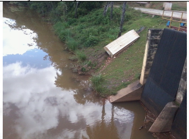
F9 – Grades de remoção de sólidos – entrada do tratamento
