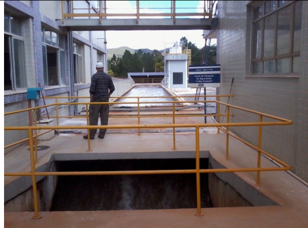
F1 - Calha Parshal – inicio do tratamento
