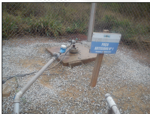
Foto 04. Poço artesiano nº 01 utilizado para abastecimento de água do Complexo Penitenciário
