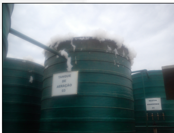
Foto 02. Espuma transbordando do tanque de aerção da ETE do Complexo Penitenciário.
