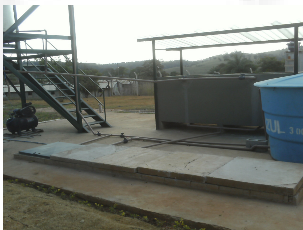
Foto 03. ETE para o efluente industrial.
