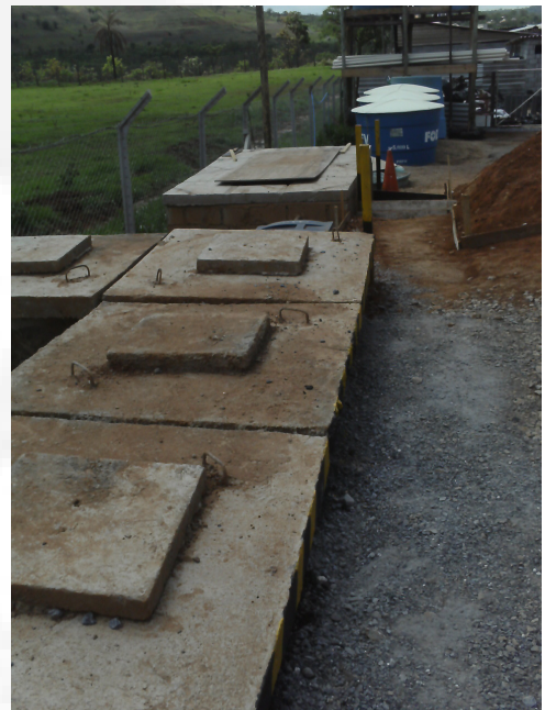
Foto 2. Sistema de separação de água e óleo.
