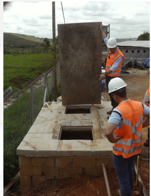
Foto 2. Sistema de separação de água e óleo.
