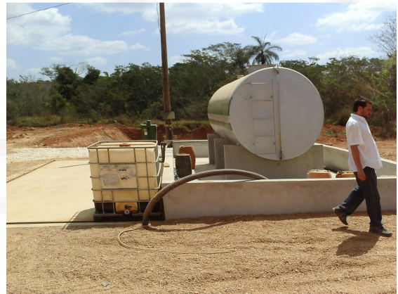
Foto 04. Tanque de abastecimento aéreo com sistema de contenção.
