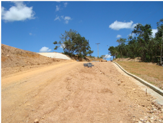
Foto 03. Sistema de drenagem pluvial instalado em via próxima à planta de beneficiamento.
