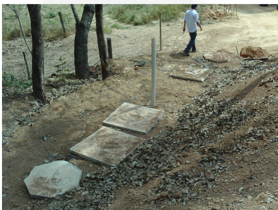
Foto 05. Sistema de tratamento de efluentes sanitários do escritório/refeitório.
