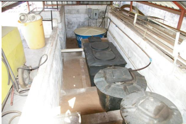
Figura 3: Caixa separadora de água e óleo do empreendimento.
