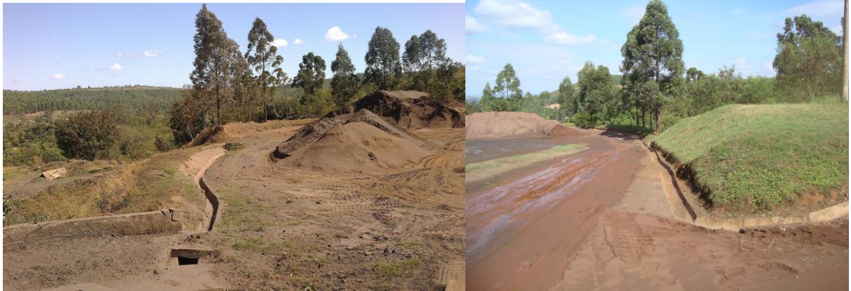
Figura 03: Drenagem de águas pluviais do pátio do empreendimento
