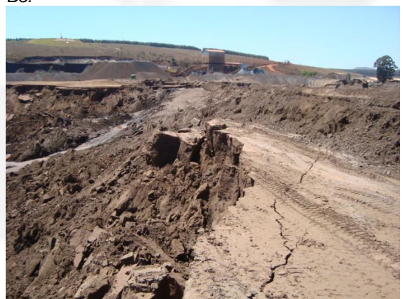
Foto 12. Vista do local no lago de deposição de rejeitos da B1 no limite da ruptura e trinca longitudinal.
