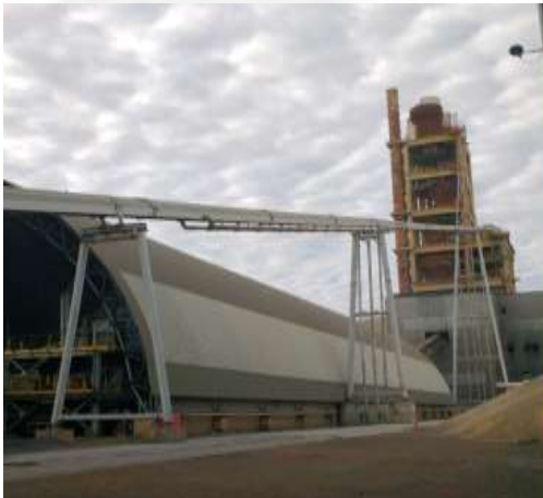
Foto 01. Tubulador que direciona o resíduo a alimentação do forno
