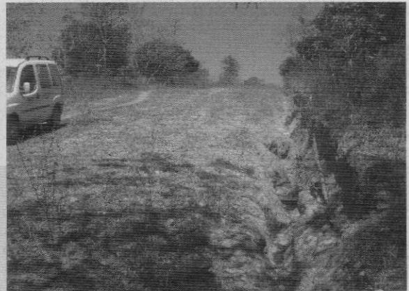
Foto 2: via de circulação sem sistema de drenagem
