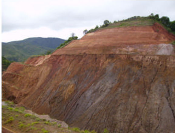
Figura 4: Movimento de massa do talude sul Fonte: Vistoria em 28/11/2008
