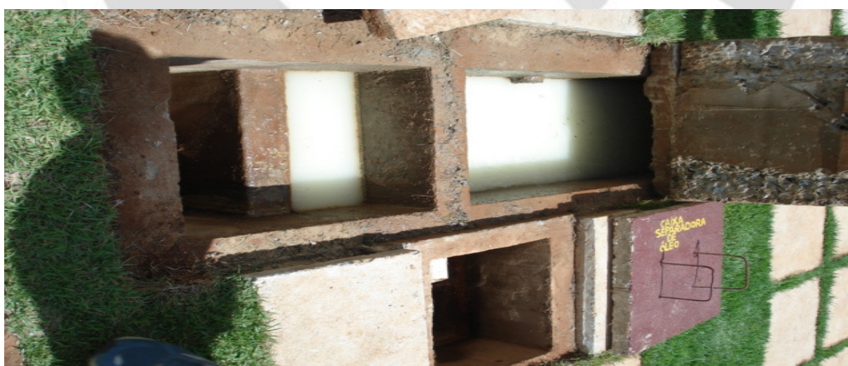
Foto 02. Caixa separadora água/óleo
