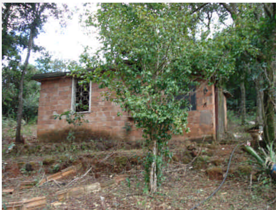
Figura 4: Construção existente na área de nascente (APP).
